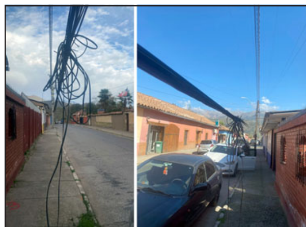
Una verdadera maraña de cables cuelga a baja altura en calle O'Higgins al llegar a Comercio en Putaendo.
