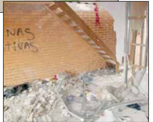
En su interior la vivienda está bastante destruida.
