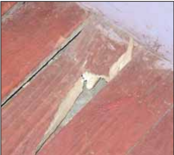
Los ratones han comenzado a hacer hoyos en las viviendas, dejando bastante afectado el piso de las casas y artículos eléctricos.
