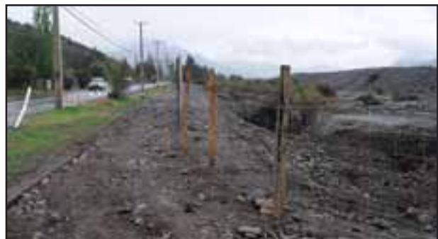
Los trabajos que está realizando la empresa ejecutora de un proyecto de extracción de áridos en el sector conocido como Las Cabritas, ha generado que el cauce de un antiguo estero esté literalmente borrado y obstaculizado.
