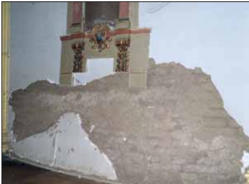
La Iglesia del Buen Pastor quedó sumamente dañada con el terremoto, actualmente está cerrada y no tiene energía eléctrica.
