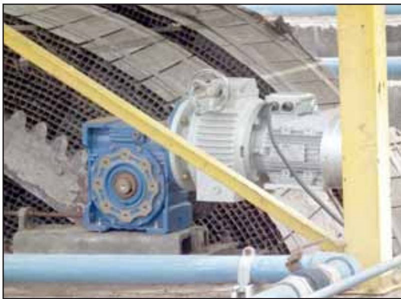
Este es el motor que está fuera de funcionamiento, esta situación viene representando un dolor de cabeza para vecinos del sector de Nuevo Algarrobal.
