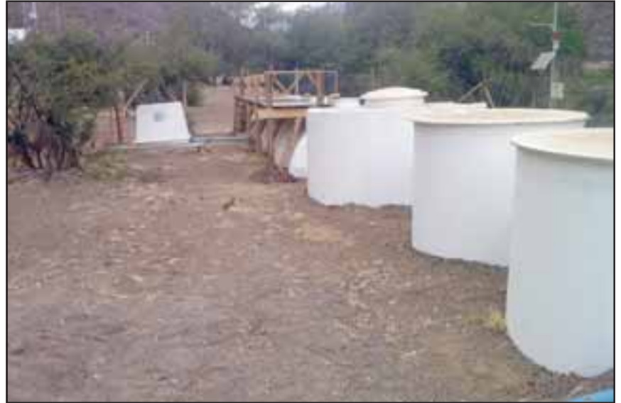
La planta de tratamiento de aguas aún no está autorizada ni tiene su resolución sanitaria al día.
