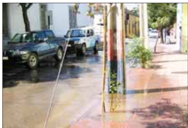
Totalmente inundada quedó la calle Papudo, entre O'Higgins y Esmeralda, debido a la rotura de una matriz de agua potable.
