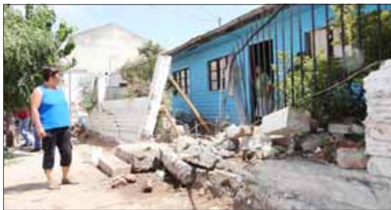
Un joven en estado de ebriedad protagonizó este violento accidente que terminó derribando la reja y el muro de esta vivienda.
