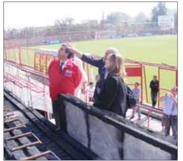
El Subsecretario de Desarrollo Regional pudo conocer los daños provocados por el incendio, el que no afectó las obras de construcción que desde hace un tiempo se están realizando en el recinto deportivo.
