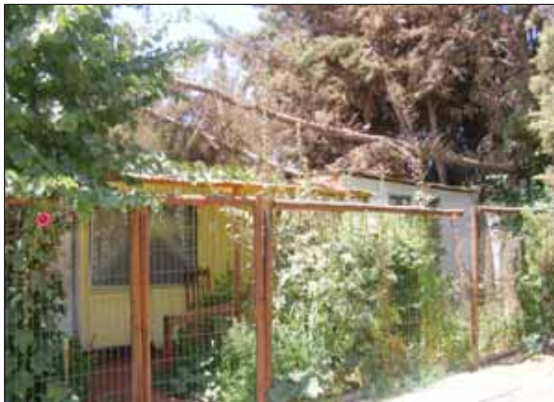
El árbol todavía está sobre la casa de María Eugenia, aplastando los cables eléctricos, una situación que preocupa a esta familia.
