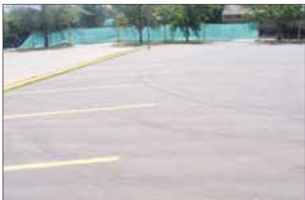
Las obras de mejoramiento contemplaron sacar el antiguo piso y colocar una carpeta asfáltica más resistente, con una duración estimada de alrededor de 20 años.
