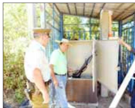
Antisociales prácticamente desmantelaron gran parte de las instalaciones de este pozo de captación de aguas subterráneas.
