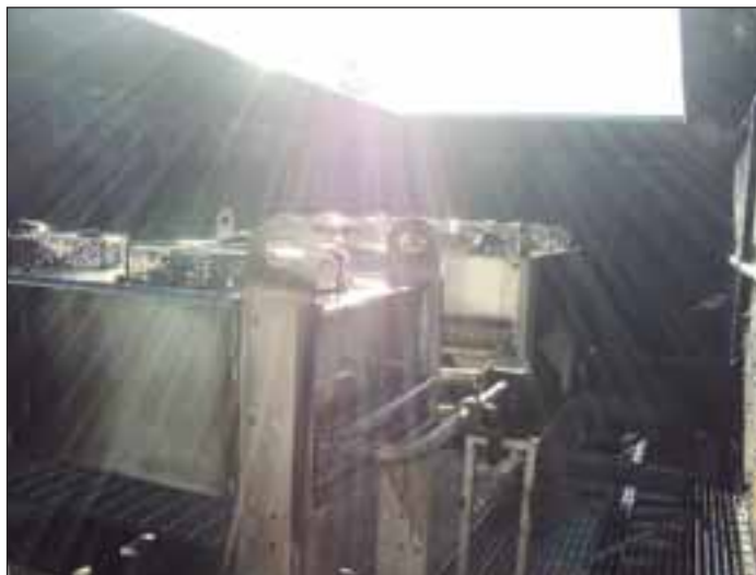
Trabajos de soldadura en el sector de refrigeración habrían originado el incendio que afectó al Supermercado Unimarc.
