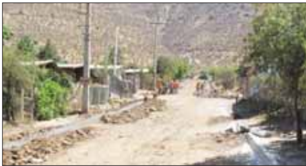
Cabe destacar que en la Población Eliecer Estay, ya se han realizado la instalación de alcantarillado y luminarias.
