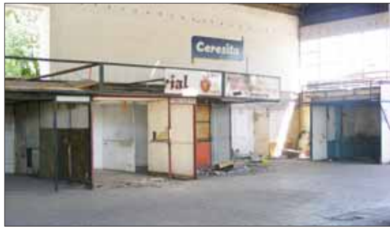
Esta semana ya se comenzó a desarrollar el desmantelamiento de las casetas que utilizan las empresas de buses.
