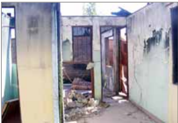
Además de los daños producidos por el incendio, que fueron cuantiosos, ahora se suma la acción de los delincuentes que han robado lo poco que quedó en la vivienda.
