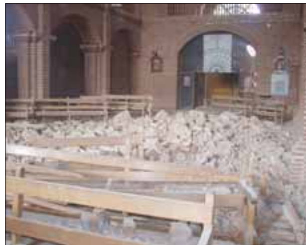
La Iglesia San Antonio de Putaendo, una de las más afectadas con el terremoto del 27 F.
