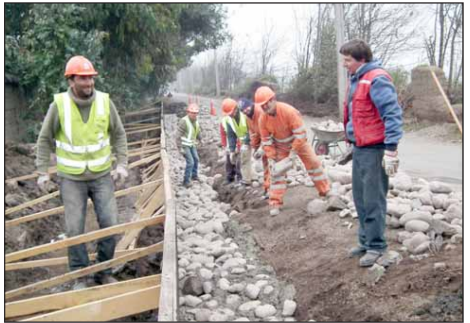
Las cámaras de Diario El Trabajo captan el momento en que decenas de obreros fabrican un sólido muro de contención en Ruta E705, kilómetro 4.750, sector de Hacienda Quilpué.
