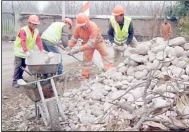
Diffícilmente el agua podría remover estas piedras, aún así, con el tiempo llegó a deteriorar el pavimento y hoy son necesarias muchas de ellas en ese muro.
