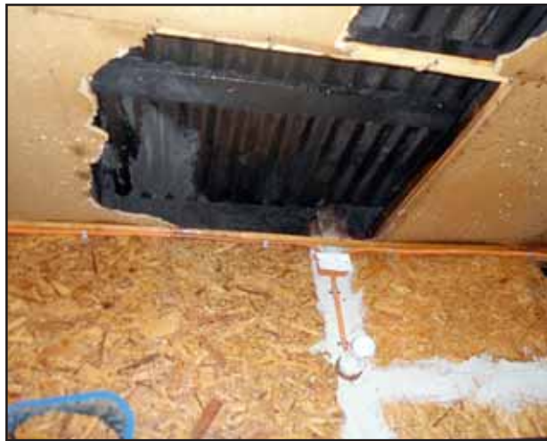
Los funcionarios policiales rompieron parte del cielo de la casa y mediante una manguera comenzaron a apagar las llamas que amenazaban con propagarse.
