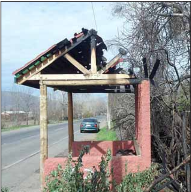
Parcialmente destruido resultó este servicial paradero.
