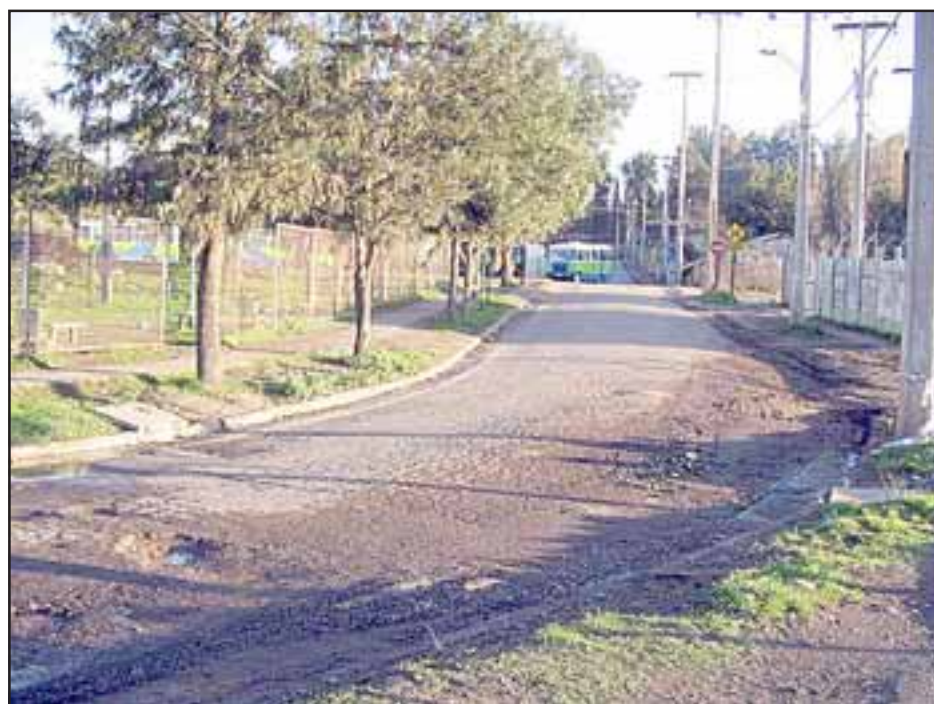
Tal como se aprecia en la imagen, el estado del pavimento de la calle Mateo Díaz es deplorable.
