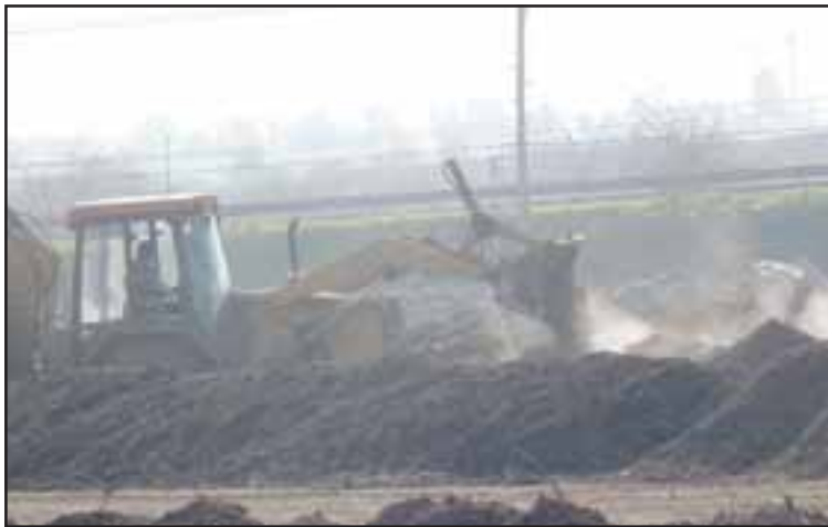
Este material orgánico sería lo que provoca los vapores y olores que impiden un sueño tranquilo, según denuncian varias familias del sector Puente Pocuro de Tres Esquinas.
