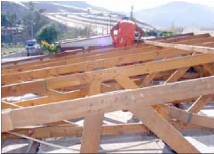
Destechadas quedaron varias viviendas en esta población, este viernes comenzaron los trabajos de reparación de los techos en Villa Nueva Algarrobal, que resultaron afectados con el temporal del fin de semana pasado.
