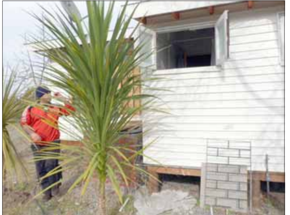
Los delincuentes arrancaron la protección metálica de la ventana del baño para ingresar a la vivienda.
