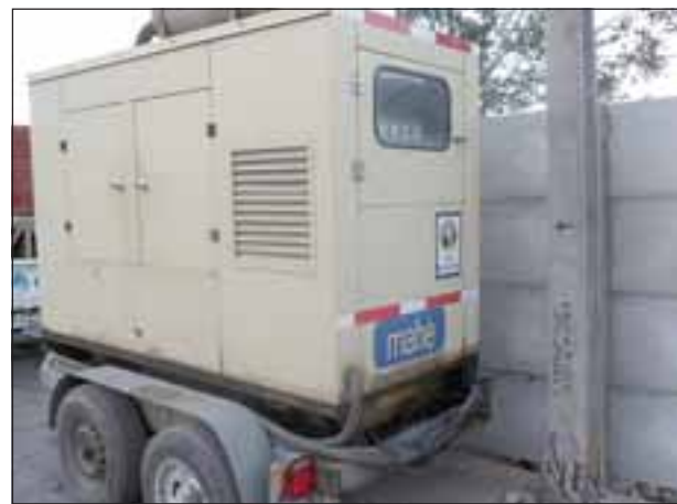
El generador fue recuperado gracias a que los ladrones se vieron obligados a abortar su plan en el camino.
