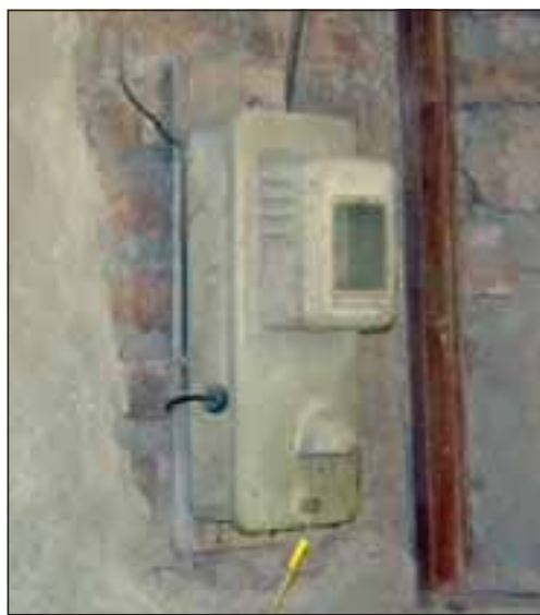
Con el pretexto de cambiar este viejo medidor, los atracadores ingresaron a la vivienda uniformados como empleado de Chilquinta.
