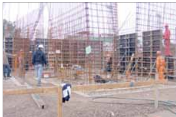
El Alcalde Jaime Amar visitó las obras de construcción de los departamentos que se ubican detrás del estadio municipal.
