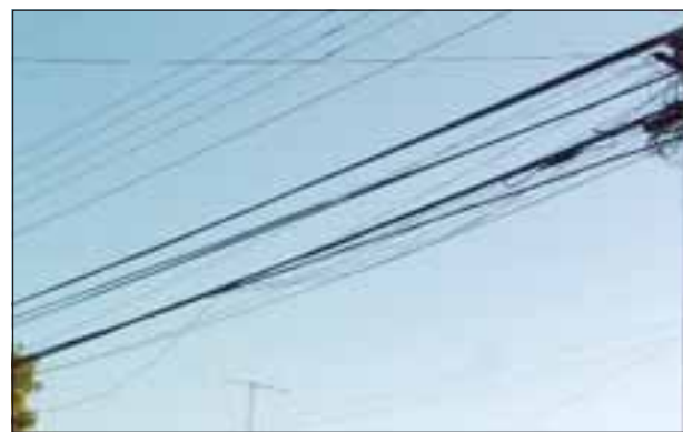
Los cables colgando a baja altura son una grave molestia al margen de un problema estético.
