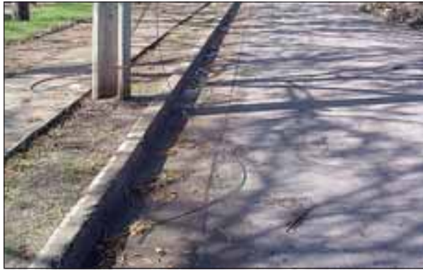
Vecinos de Villa Alborada denunciaron la emergencia a Chilquinta, pero aún no solucionan el problema y temen que los cables estén energizados.
