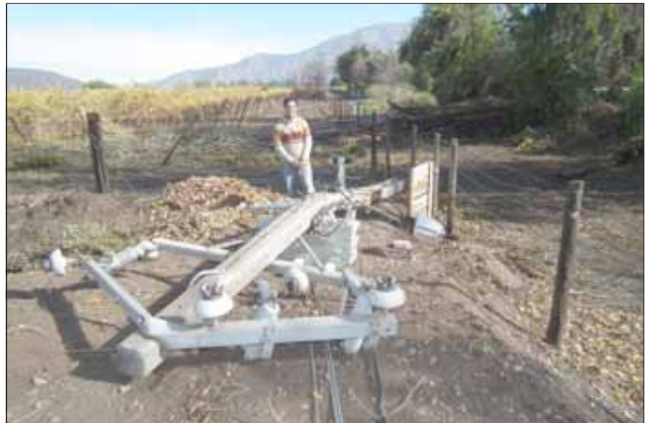
En callejón Los Naranjos la caída de un viejo árbol se encargó de sacar de servicio un gran trayecto del alumbrado público. Este daño mantiene sin electricidad a todo Algarrobal.
