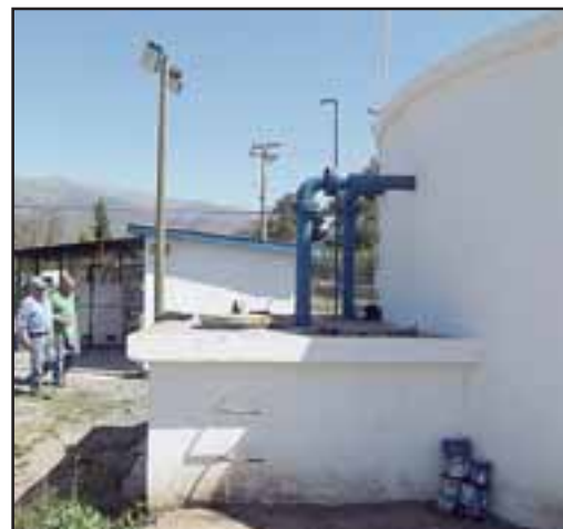
Las dos roturas de matriz sufridas vaciaron los estanques, los que no han podido ser llenados completamente generando el desabastecimiento.
