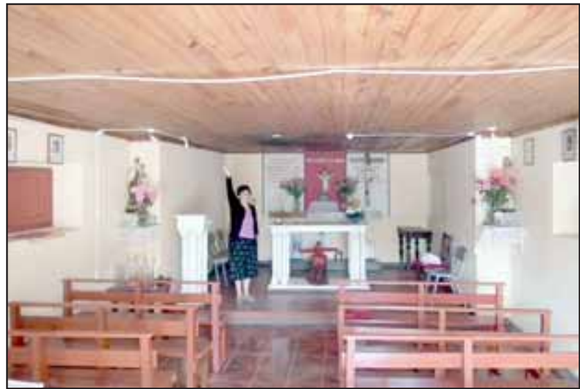
La señora Jenny Valencia muestra a Diario El Trabajo el problema que tienen, pues el techo de esta capilla sólo llega a 2.50 metros y necesitan subirlo un metro más.
