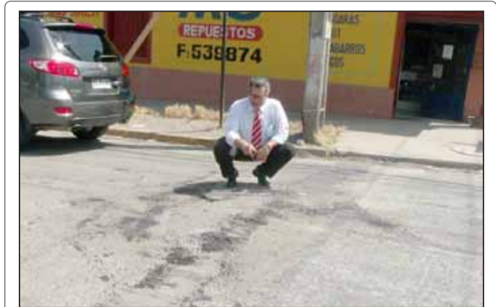
Hasta la esquina de Tacna Norte con Maipú se trasladó este jueves personal de la Dirección de Tránsito y del Departamento de Aseo y Ornato, con la finalidad de tapar el bache ubicado justo en ese sector, el cual representaba una enorme molestia para los automovilistas. La iniciativa del alcalde Eugenio Cornejo ha sido aplaudida por los conductores, pues a pesar de tratarse de una solución transitoria, entienden que da cuenta de la disposición de la autoridad por resolver los problemas de la gente.
