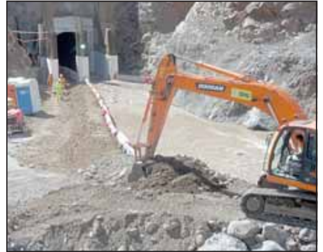
Con el desvío de las aguas del Río Rocín se comienza la etapa de construcción de la cortina para el embalse Chacrillas.
