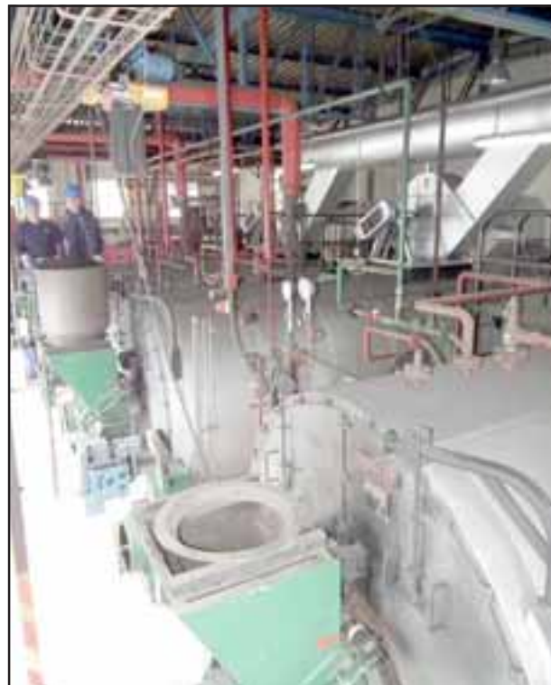
En la Unidad de Calderas, cada empleado debe ser responsable y exacto en su parte del trabajo, pues las temperaturas son muy altas. En la foto vemos a Claudio Montenegro y Manuel Irrázabal.
