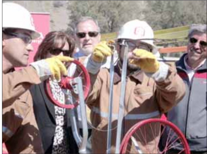
Los técnicos de Chilquinta hicieron una demostración del efecto del hilo curado, enseñando como cortaba un cable eléctrico.
