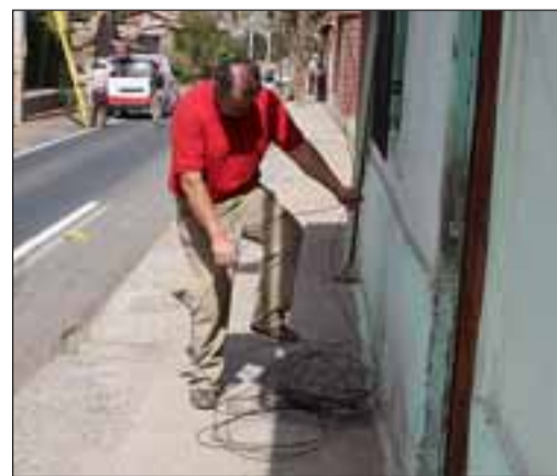
Así quedaron los cables en gran sector de Calle Brasil en Putaendo, luego que un camión los reventara a su paso.
