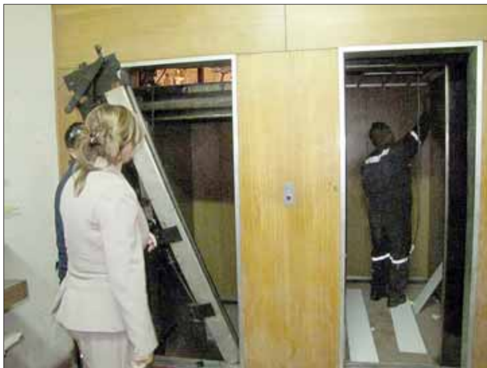
La empresa ya se hizo cargo de los trabajos y retiró las antiguas estructuras que serán reemplazadas por modernos ascensores que cumplen los más altos estándares de seguridad.
