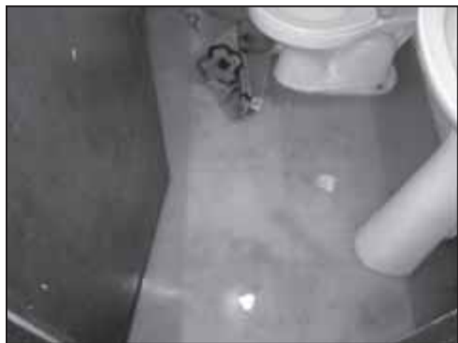
Varios centímetros de agua llenaron las dos casas, razón por la cual Esvál tomó cartas en el asunto para dar solución a los angustiados vecinos.
