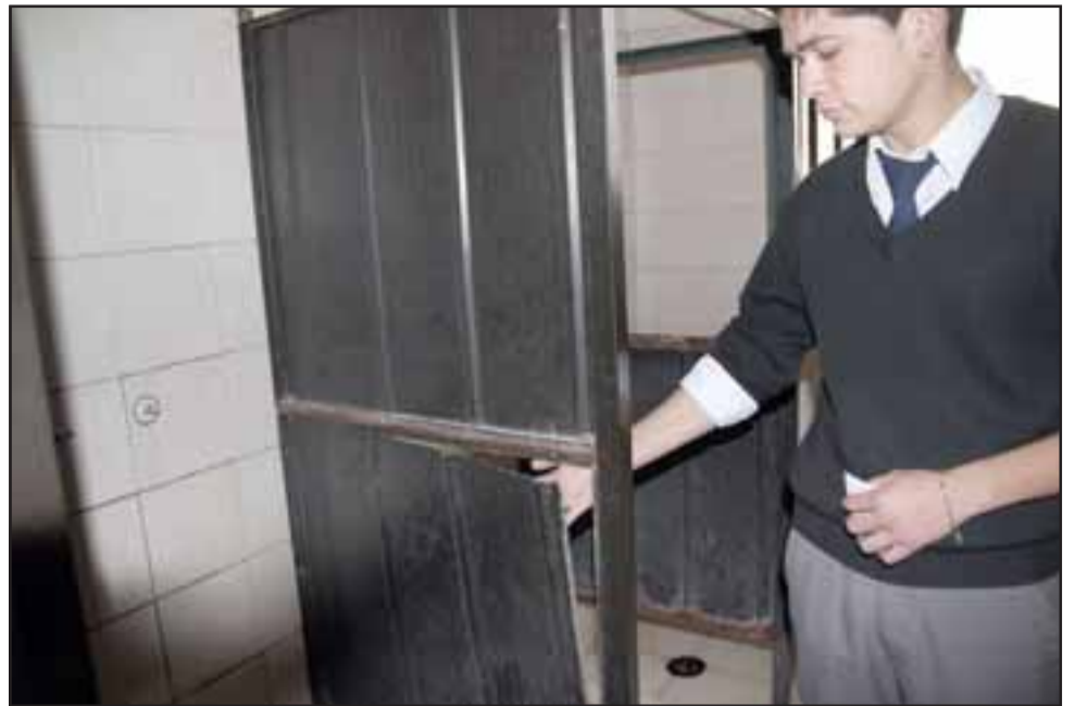
Pese a que el Director del Daem dijo que los baños están buenos, la foto muestra el deterioro y peligro que existe en el lugar.
