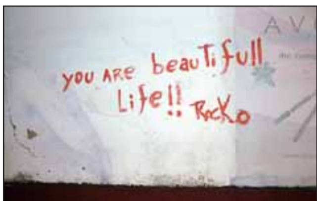
Así quedó la pared de la vivienda luego que 'Rocko' visitara la zona típica de Putaendo, por lo cual fue detenido.
