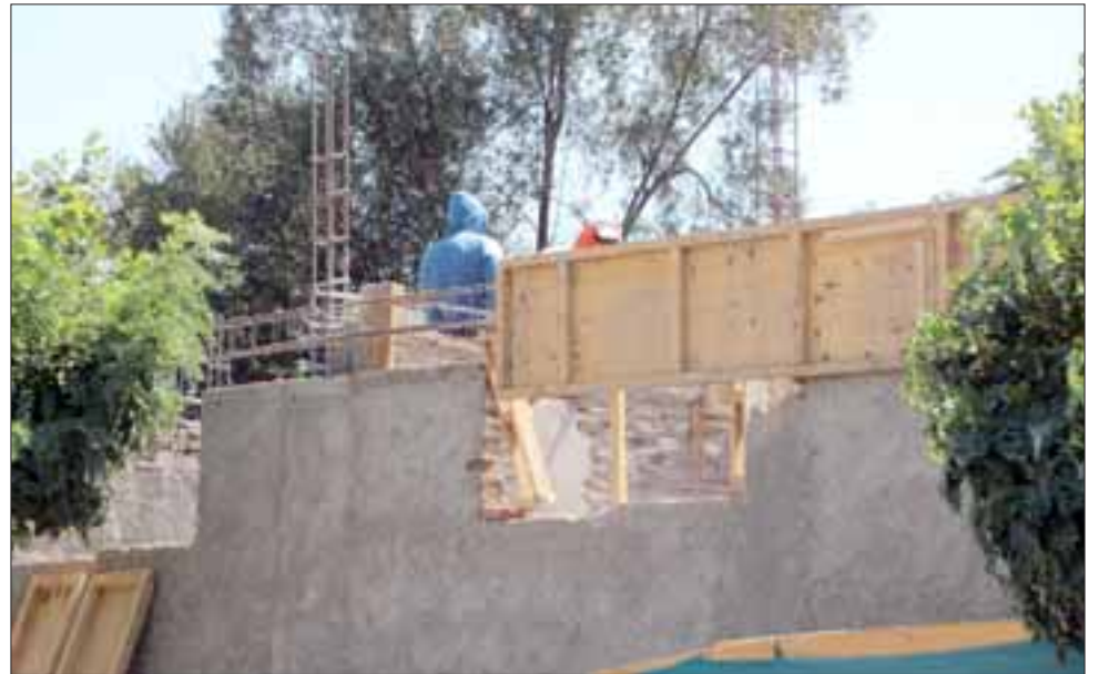
El Departamento de Obras de la Municipalidad de Putaendo notificó a la empresa que construye el nuevo complejo deportivo La Bombonera, que debe paralizar las obras y proceder a la demolición de varios trabajos luego de corroborar una grave denuncia recibida en los días anteriores.
