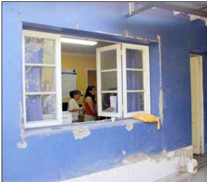
El o los sujetos arrancaron por completo la protección de fierro de un ventanal para ingresar al recinto.
