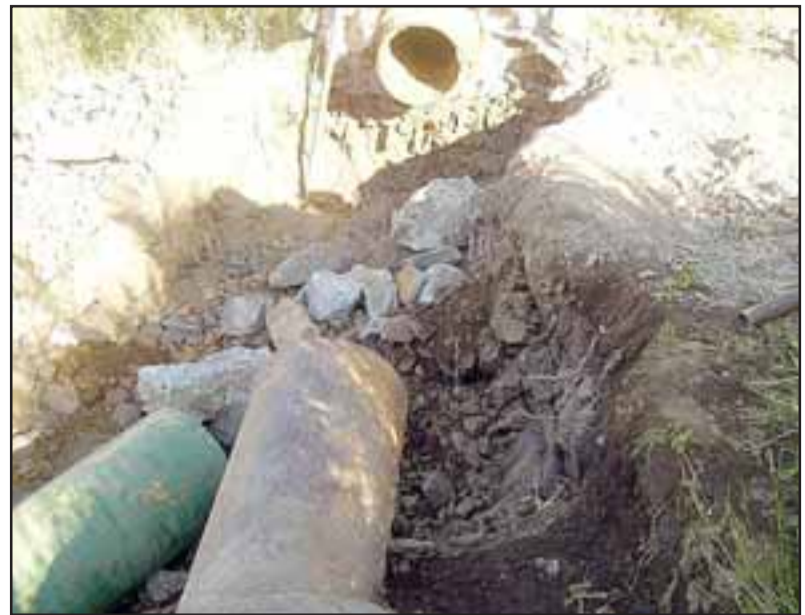
El hecho se remonta a julio del año pasado, cuando los sujetos cortaron y sacaron trozos de tubería que fueron amontonando en una carretilla.
