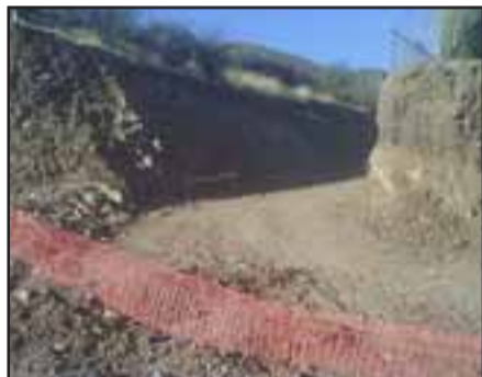
Producto de obra en el sector, la empresa constructora mantiene bloqueado el acceso al camino del cerro, por lo cual no pueden ingresar vehículos para abastecer de agua a las especies arbóreas.
