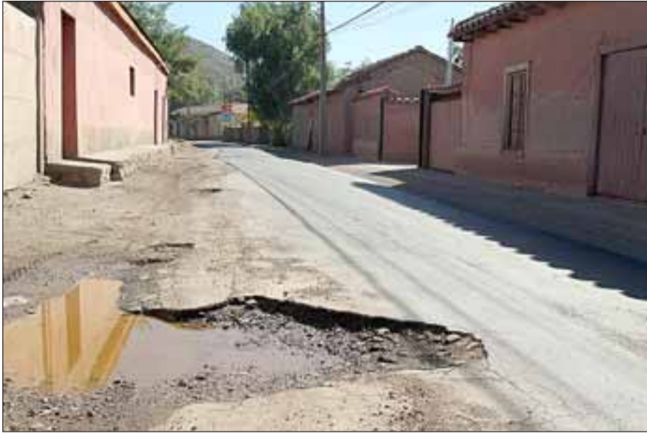
A través de esta foto denuncia, esperamos que quien corresponda, sea Vialidad o el municipio, puedan intervenir lo antes posible para tapar como corresponde este peligroso hoyo, que además día a día crece en diámetro y profundidad.
