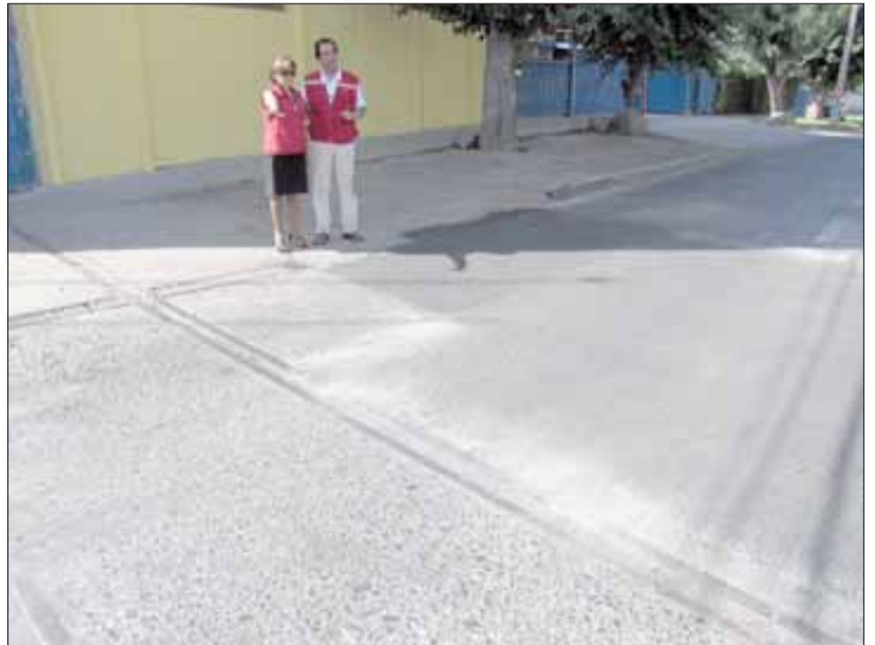
Alrededor de 50 metros cuadrados de loza de hormigón fueron removidos y reemplazados con mezcla asfáltica en caliente, con un costo aproximado de 8 millones de pesos.
