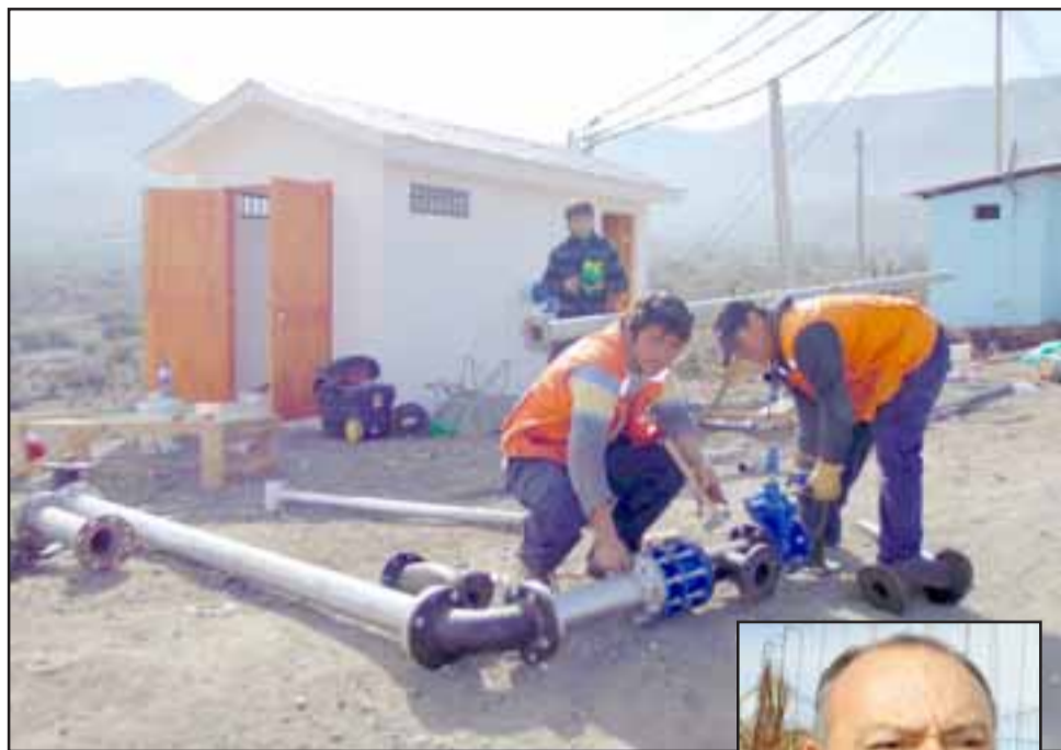
Los obreros de la Constructora Gonzalo Orellana manipulaban la mañana de este martes la parte hidráulica del pozo emergente, a fin de realizar unas pruebas de bombeo previa a la habilitación del recurso hídrico.
