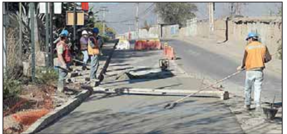
La iniciativa era evitar que se produjeran diferencias de cota entre ambos pavimentos que a futuro generarán problemas para el flujo vial.
