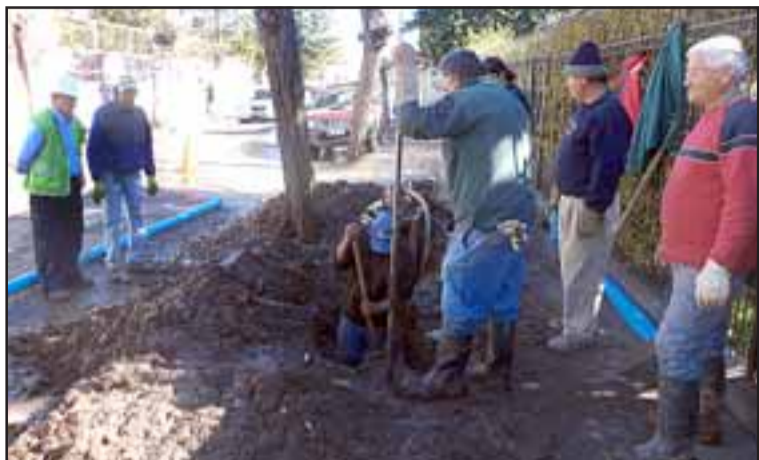
Equipos de Esvál trabajan en lugar para reponer suministro de agua, luego que la matriz en el sector central de la ciudad de San Felipe se rompiera.
