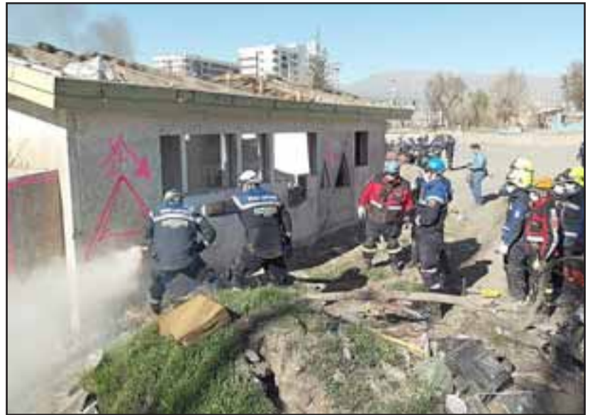
Los profesionales en rescate y control del fuego, se entregaron totalmente en este curso que los capacita para enfrentar el manejo de estructuras colapsadas.
