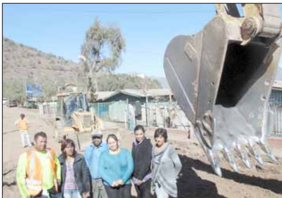
Varias de las integrantes del comité pro-pavimentos de Algarrobal, visitaron durante la mañana de este jueves el lugar donde se realizan las obras del Serviu, en Algarrobal centro.
