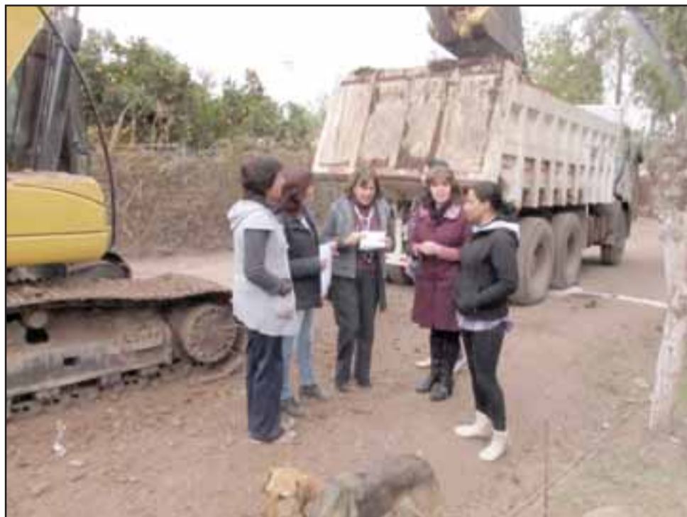
La Gobernadora Patricia Boffa junto a la Delegada Provincial del Serviu, María Alicia Galdames, visitaron los trabajos para ver el avance de la obra.
