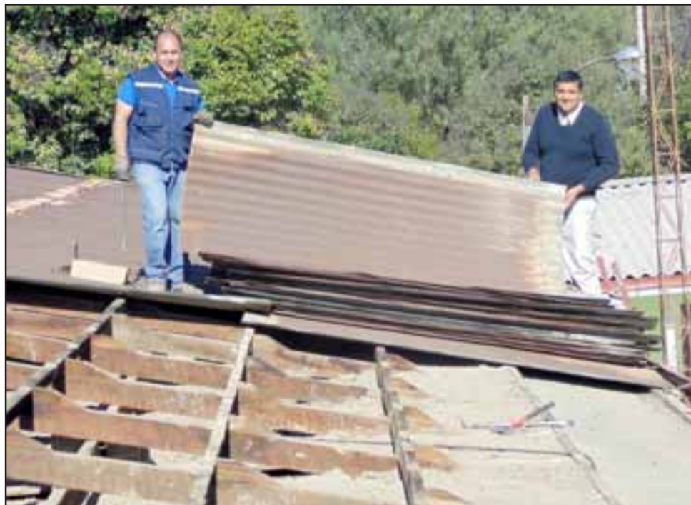
El propio director de la escuela, Ricardo Yáñez, supervisa personalmente los trabajos en el techo de la estructura. Estas planchas no son cambiadas desde hace medio siglo.
