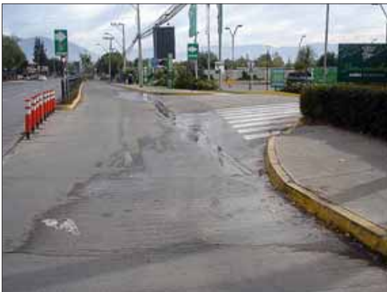
La rotura de la matriz frente al Jumbo lleva ya cuatro días y aún no acude alguien a repararla.
