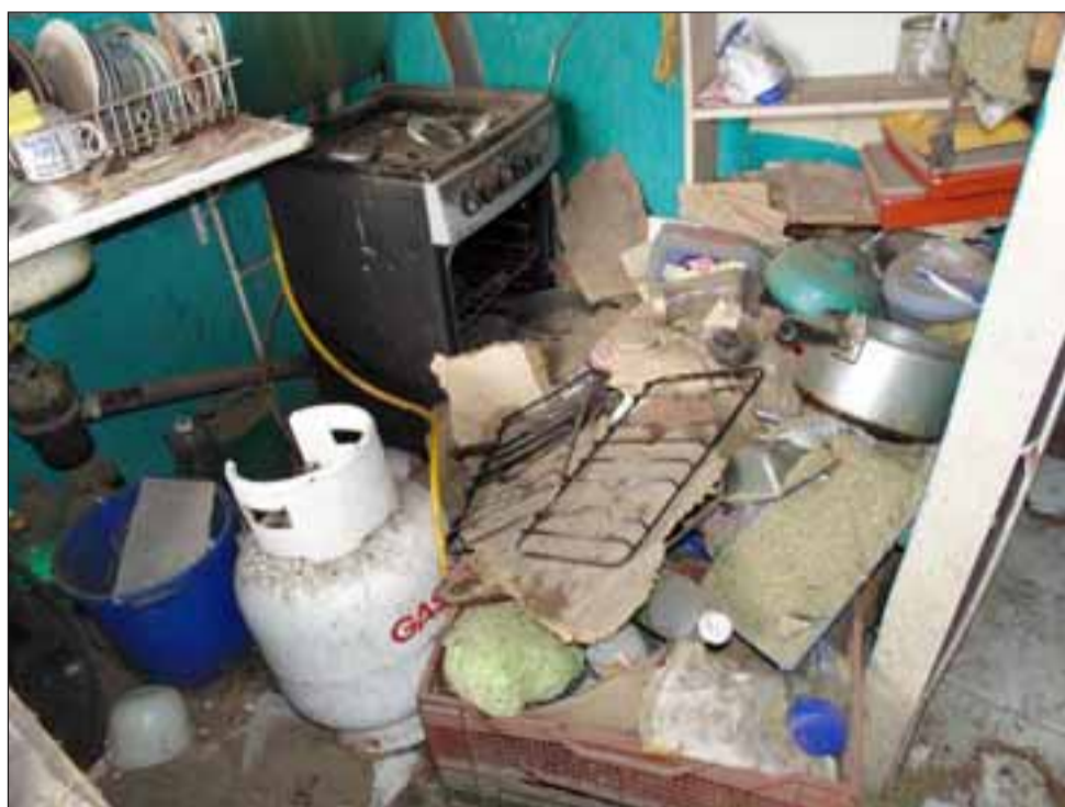
Así quedó la cocina de José Bastián tras la explosión, luego que una fuga de gas se produjera horas antes del percance.
